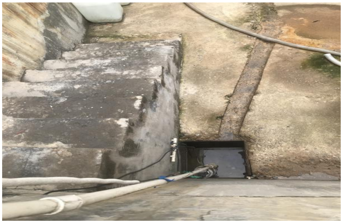
事故废水转移泵
