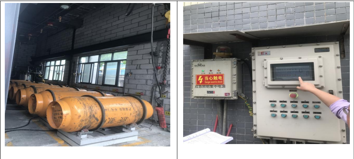
液氨气化室（通风措施）
