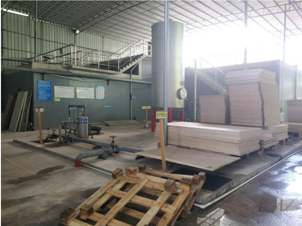
图 4.1-4 污水站内部图片
