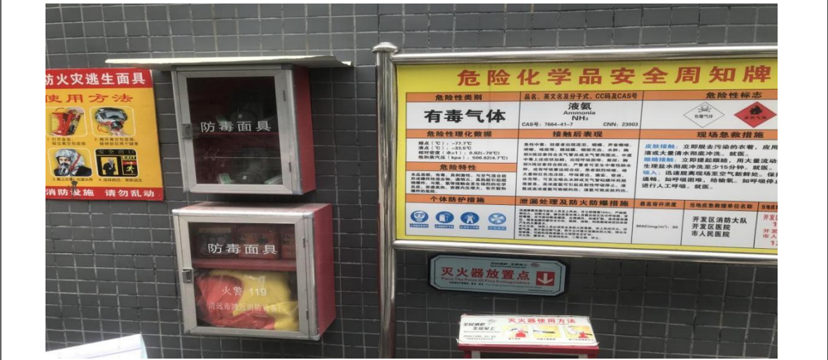
液氨气化室外防护装备/液氨 安全周知牌
